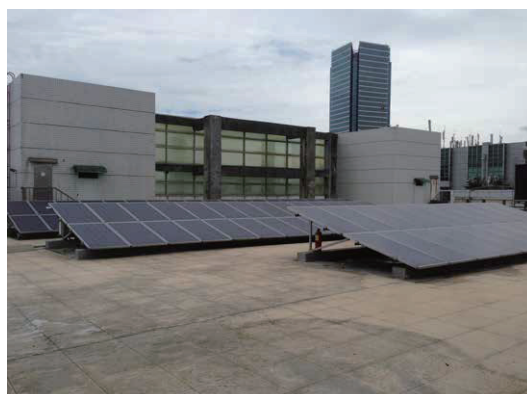
台北總部頂樓架設太陽能板
